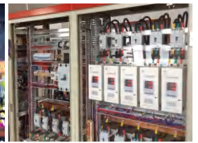
Industrial Control Cabinet 工业控制柜
