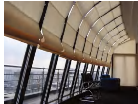
Daylighting Control 采光控制
